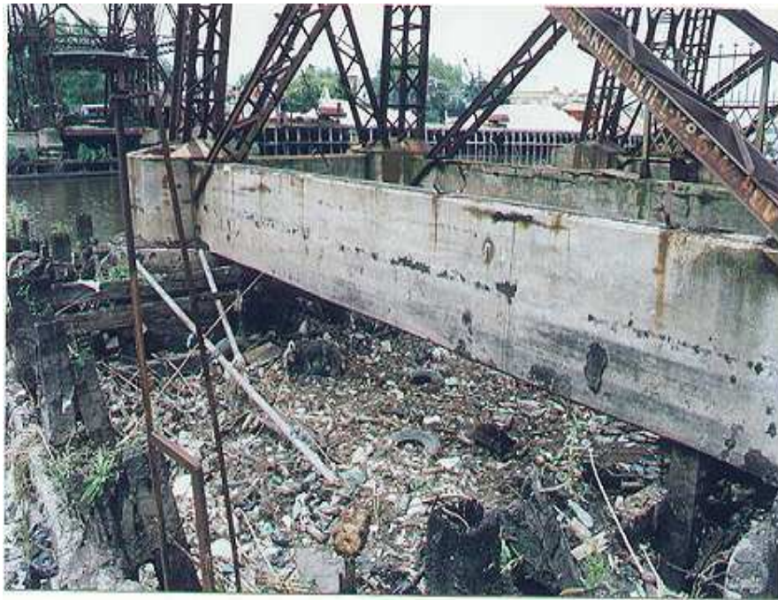
Curso de agua totalmente ocupado y cubierto de residuos
